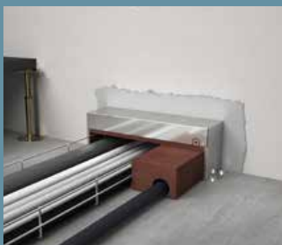
Mise en place du bloc d'insert découpé dans les espaces vides plus grands
