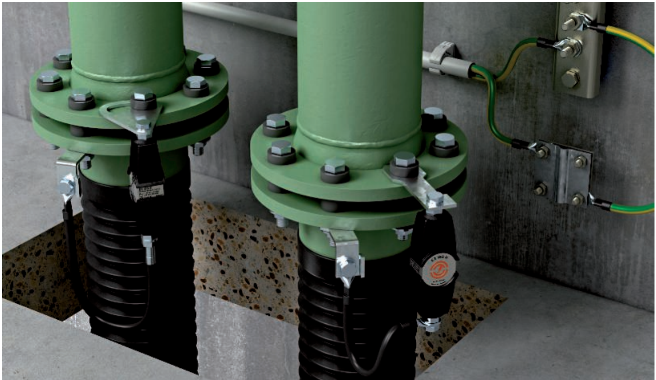
Scheidingsvonkbaan op isolatiestukken gemonteerd
