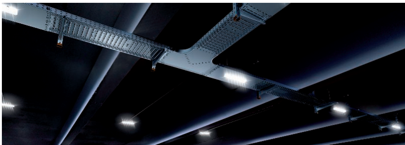
LED-verlichtingssysteem in een parkeergarage
