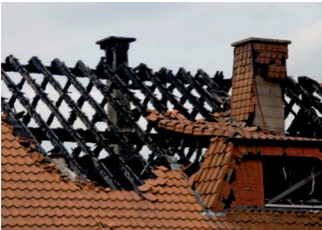
Schade aan gebouw door directe blikseminslag
