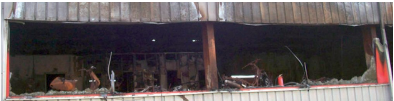
Brandschade door corrosieve gassen
