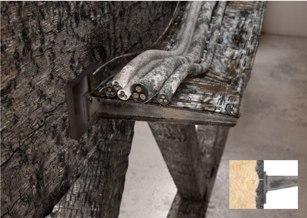
Opstelling op houten draagstructuur na brand
