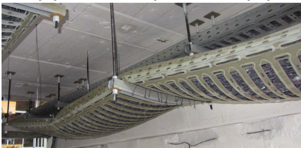
Bild 2: Verformte Kabelrinne nach der Brandprüfung
