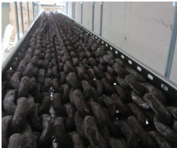
Bild 1: Belegung der Kabelrinnen mit Stahlketten
