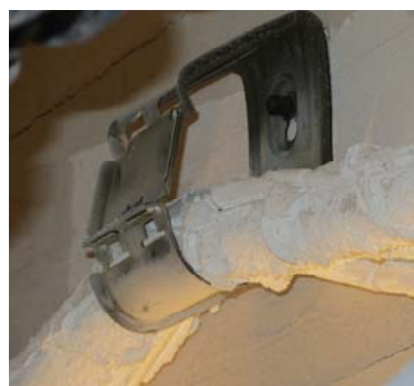
Bild 6: Verformung bei Wandmontage
