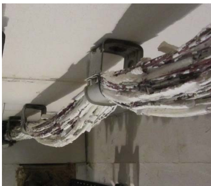
Bild 7: Durchhang der Kabel nach einer Brandbelastung von 90 Minuten
