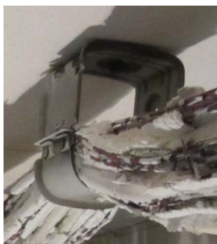
Bild 5: Verformung bei Deckenmontage
